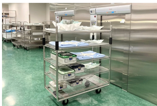
壁際に2台の高圧蒸気滅菌器（サクラ精機）
